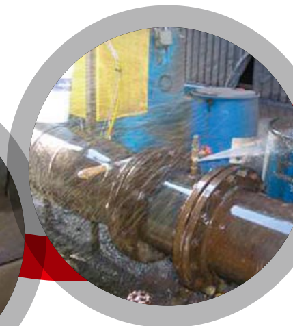
Étanchéité de tuyaux fuyants
